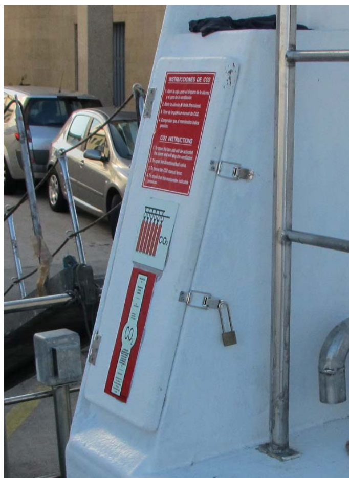
Figura 7. Instalación fija de CO 2
